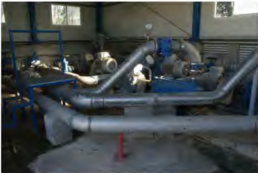
Figura 28. Fotografía del sistema de bombeo. (Fuente: autor)
